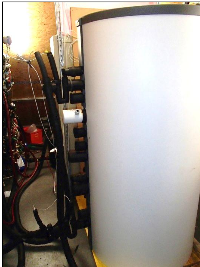
Abbildung 1 Ein Speicher installiert auf dem Prüfstand des SPF. Alle Anschlüsse sind siphoniert und isoliert.
